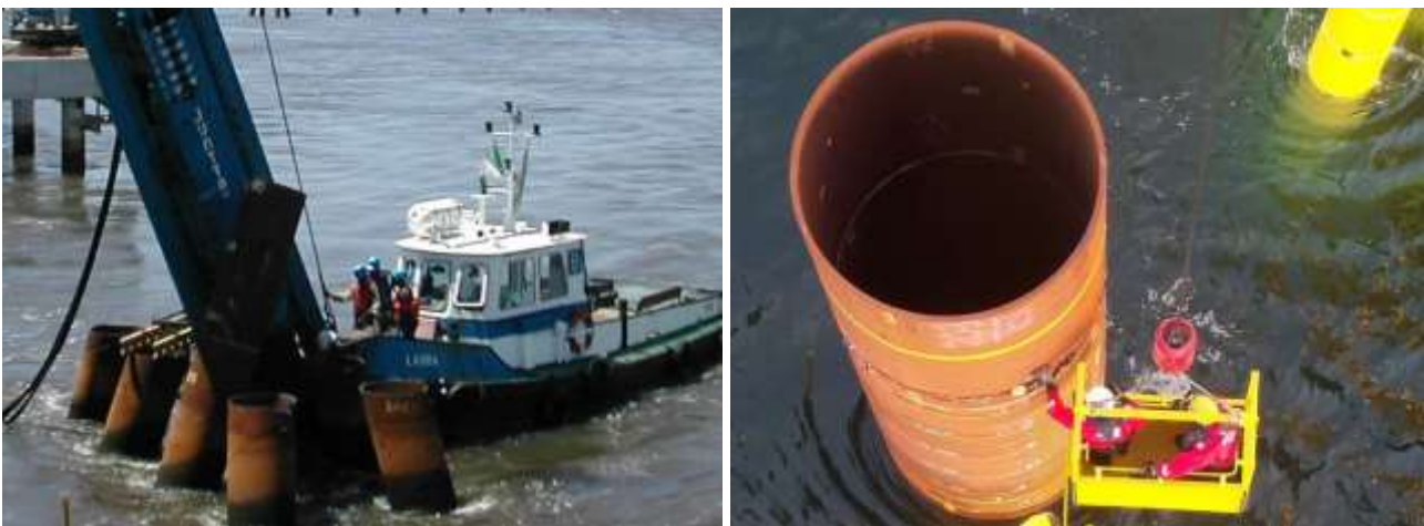
Bild 6: Zugänglichkeit des Pfahls für die Montage von Sensoren beim Nachrammen (links: vom schwankenden Boot, rechts: vom Mannkorb)
